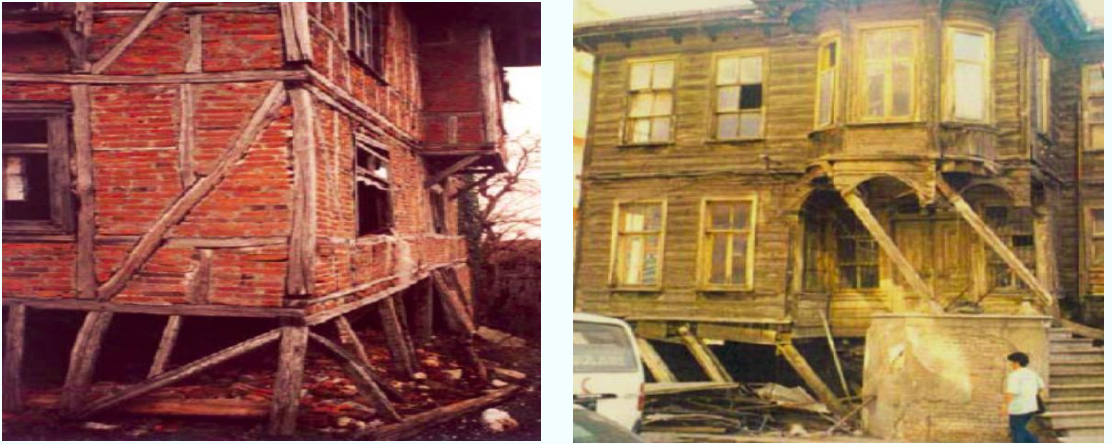
Şekil 2. 16 Yumuşak kat düzensizliği sonucu oluşan hasarlar [21]
