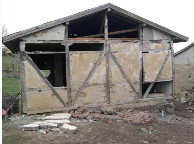
Şekil 2. 12 Depremden sonra dolgu malzemesinin dökülmesi [19]
