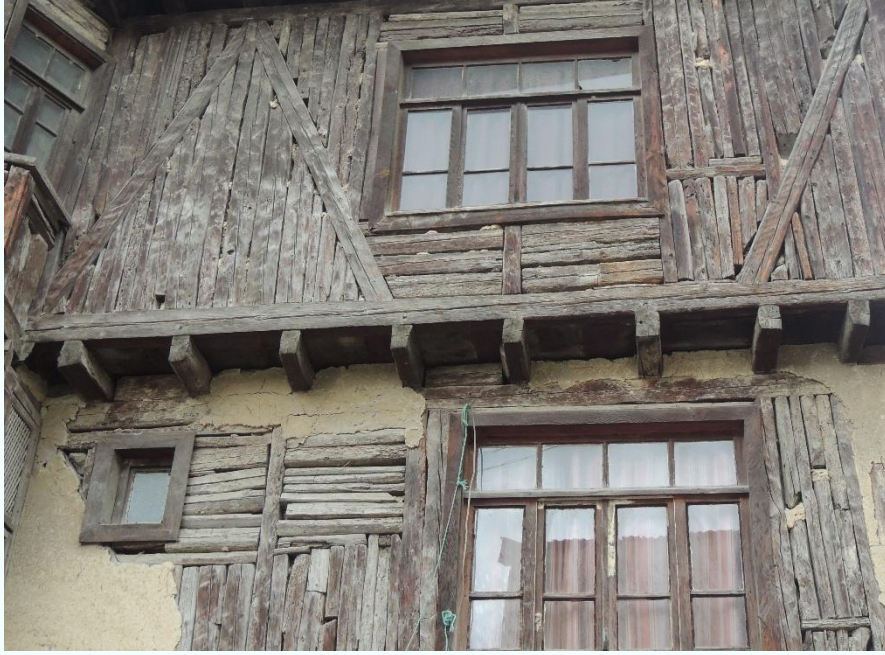
Şekil 3. 18 Dizeme ahşaplarının sıva tutmaması, Safranbolu, Bulak Köyü
