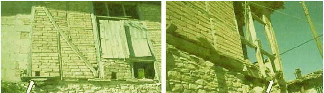
Şekil 2. 14 Ahşap dikmelerin temel üzerinde kayması [20]
