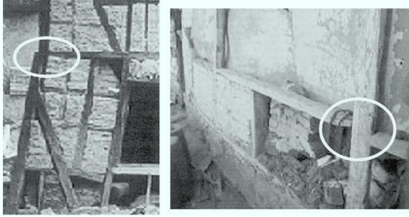
Şekil 2. 13 Deprem sonrası bağlantı yerlerinde oluşan hasarlar [20]
