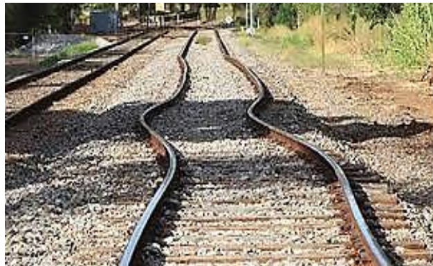
Şekil 4.5. Çeşitli etkenlerden dolayı yolun bozulması
