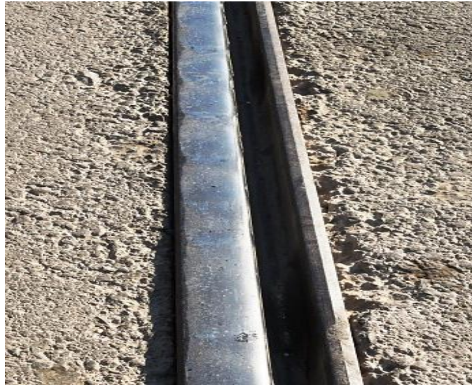
Şekil 4.26. Ray yüzeyinde ondülasyon (Konya tramvay hattı, Foto E. Sevil)
