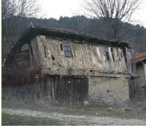
h) Yıkık çatı örneği (Çataklı mahallesi)
