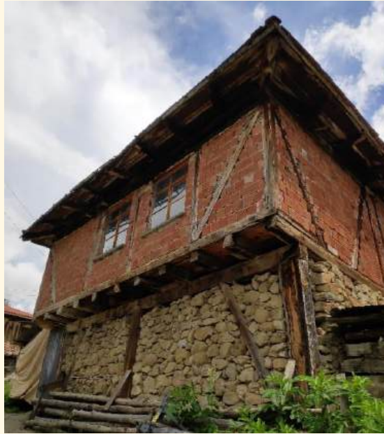
Şekil 4.29. Döşeme kirişlerinin cepheye yansımaları
