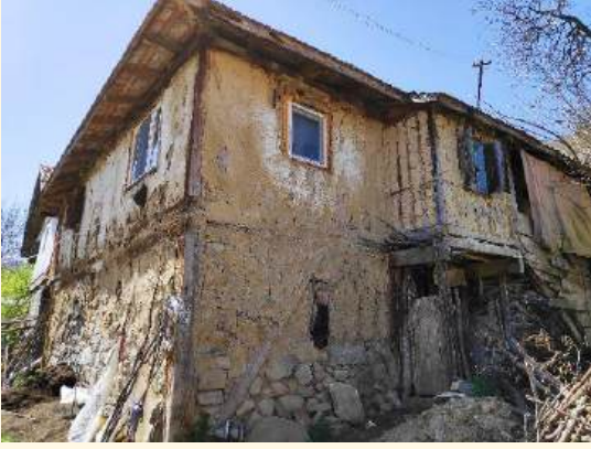
c) Az değişmiş yapı örneği (Çataklı mahallesi)
