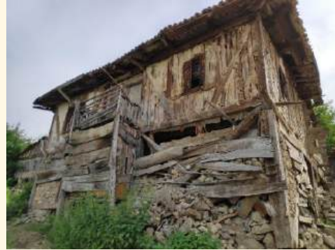
f) Kötü durumda yapı örneği (Dudan mahallesi)
