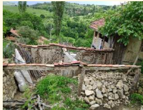
h) Harabe durumda yapı örneği (Çatakli mahallesi)
