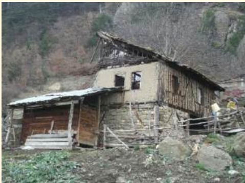
g) Harabe durumda yapı örneği (Aşağı Kayalar mahallesi)
