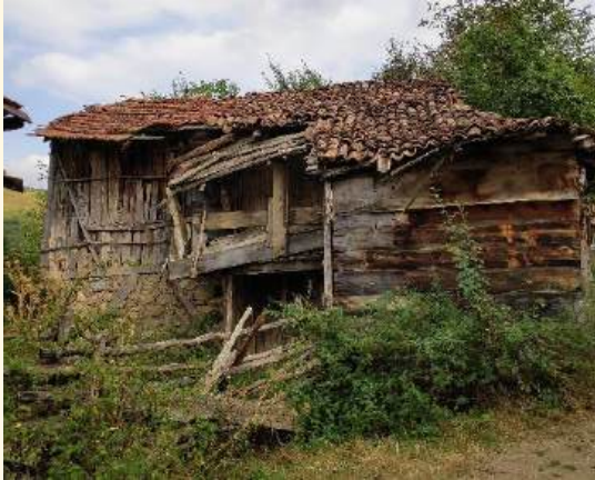
g) Yıkık çatı örneği (Dudan mahallesi)
