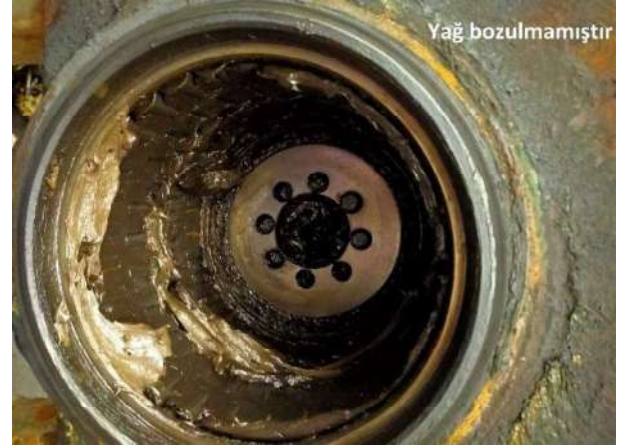
Şekil 10. QUAKERTEK CS 4015-EPR gres servis sonrası durumu
