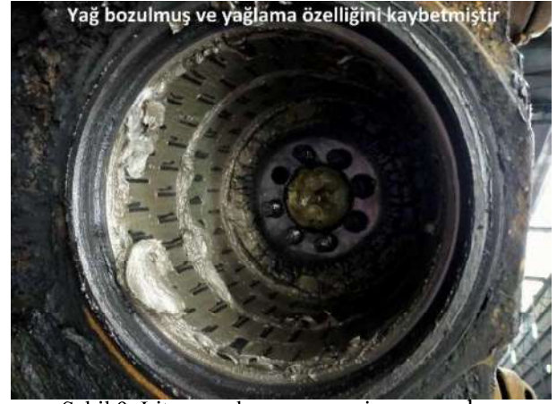
Şekil 9. Lityum sabun gres servis sonrası durumu
